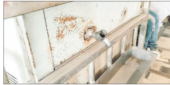
बस स्टैंड की टूटी हुई नल की टोंटी
